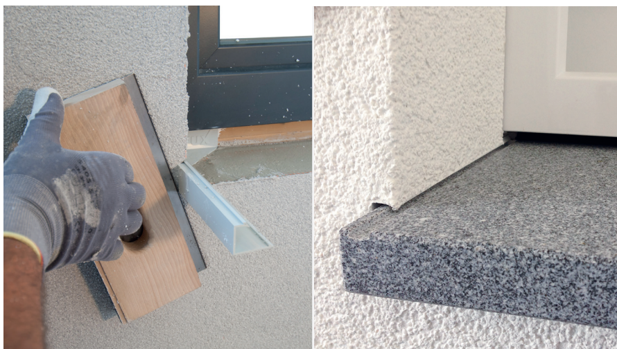
С инструмента RÖFIX SOL-PAD се реже лайсната за мазилка RÖFIX SOL-PAD на разстояние 2 mm, след което се монтира подprozоречния перваз.
