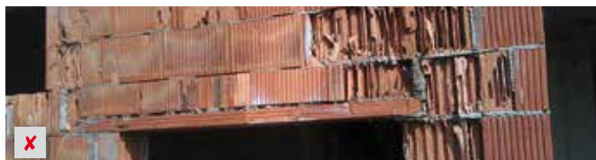
Дефектна тухлена зидария
